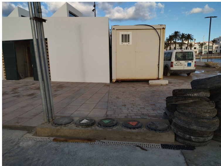
IMAGEN DE LAS BOCAS DE CARGA
